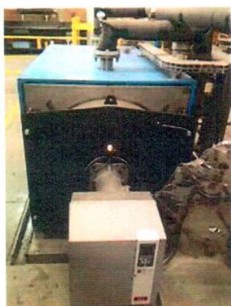
Fig. 02. Queimador – aquecimento do banho
