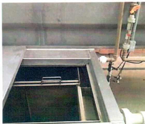
Fig. 04. Tanque de água para enxágue
