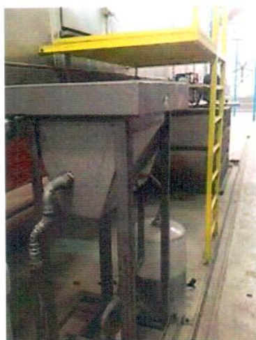
Fig. 03. Sistema de separação de óleo do banho
