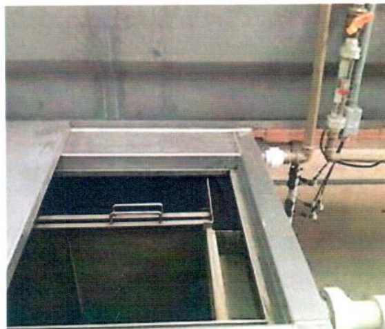
Fig. 04. Tanque de água para enxágue
