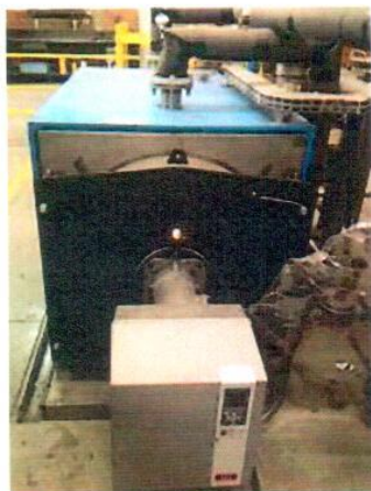
Fig. 02. Queimador – aquecimento do banho
