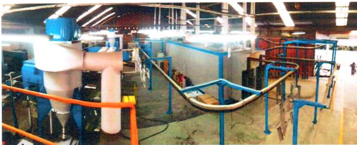
Figura 01. Panorâmica da linha de pintura da empresa
