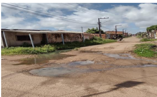
Situação precária no cruzamento das Ruas da Prata e Rubis na região do Pontal da Ilha
