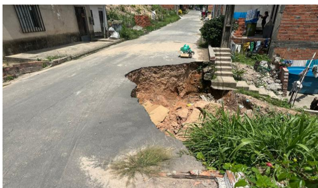
Situação precária da Rua Projetada, conhecida como "Buraco Fundo"
